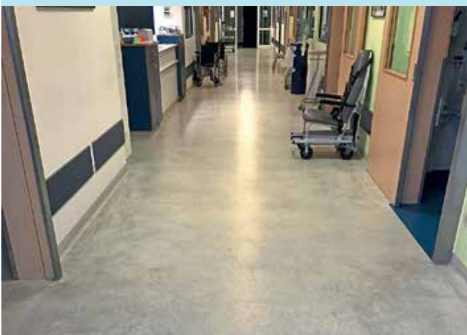
So sah der 20 Jahre alte Boden vor der Sanierung aus.
